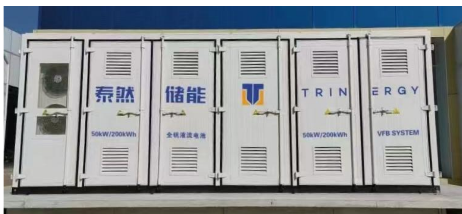
图 2-5-2 50kW/200kWh 全钒液流电池系统
